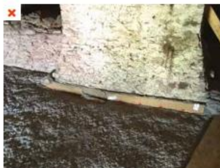
Absence de coffrage rigide et non respect de la distance de sécurité. L'isolant non combustible mis en oeuvre ne permet pas d'assurer la distance nécessaire. ©AQC
